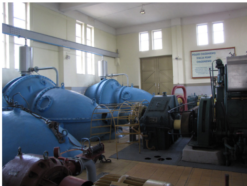
Fot. 6. Hala pomp w stacji pomp „Chłodniewo” w Tujsku (fot. M. Szubert)
